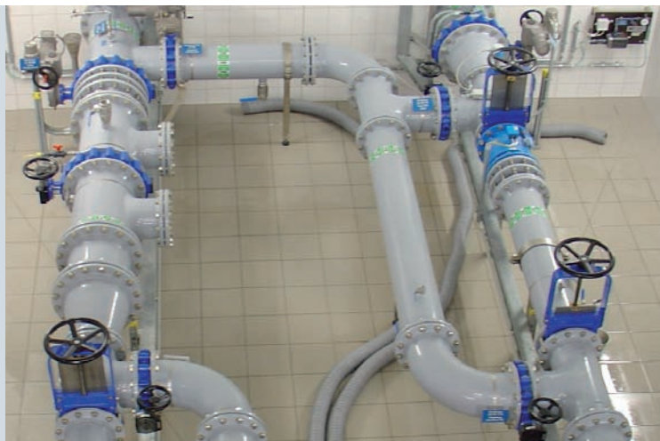
BILD 8: Polyamidbeschichtete Rohre in einer Schieberstation für Trinkwasser
